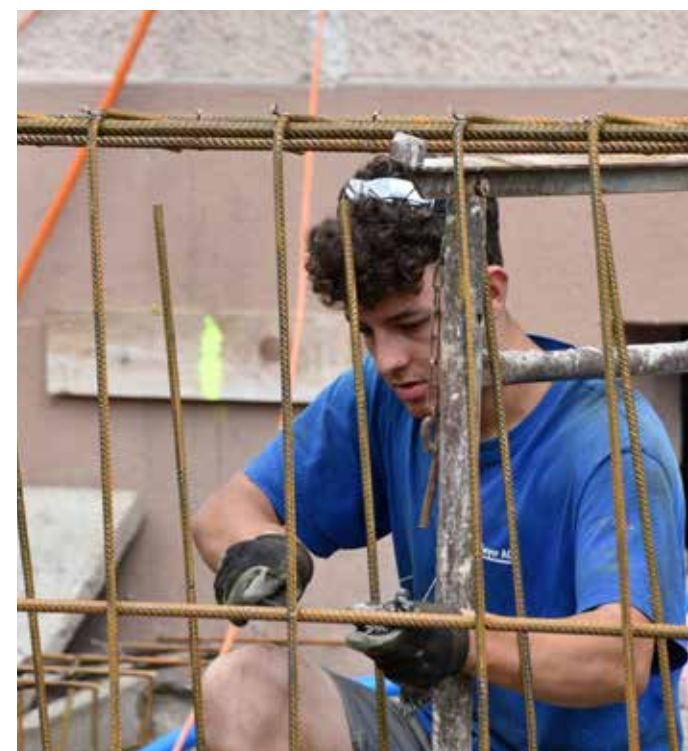
David Näf beim Binden eines Armierungkorbes für das Streifenfundament. «Mir gefällt die Vielfältigkeit des Maurerberufes.» (Gestelltes Bild, deshalb ohne Schutzbrille und Schutzhelm).
