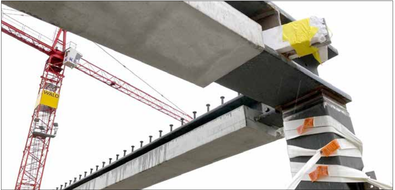
Die Stahlträger mit Kragen.
