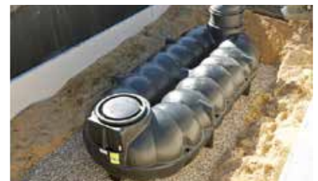
Regenwassertank 10'000 Liter unterirdisch.
